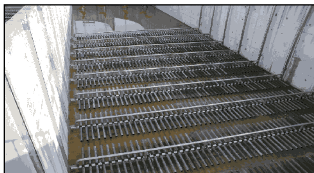
Slika 5 – Aeracija Figure 5 – Aeration
